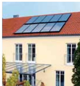
Vitosol 200-FM en viviendas adosadas
