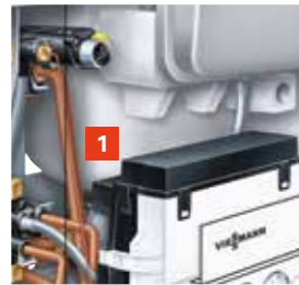
1 Acumulador de 46 litros
