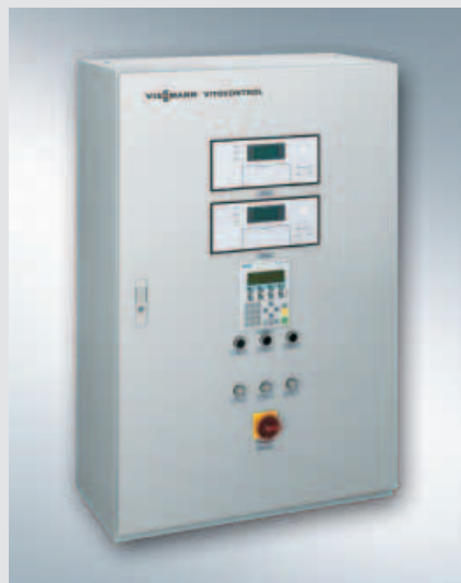
Cuadro eléctrico Vitocontrol Viessmann
